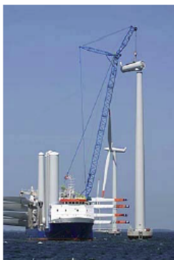
Vindkraftpark offshore vid Nysted i Danmark
